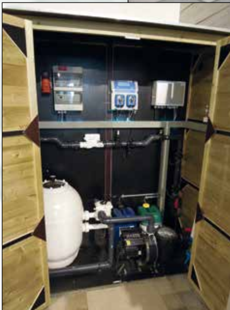
techno kast voor zwembadinstallatie Sint-Oedenrode
